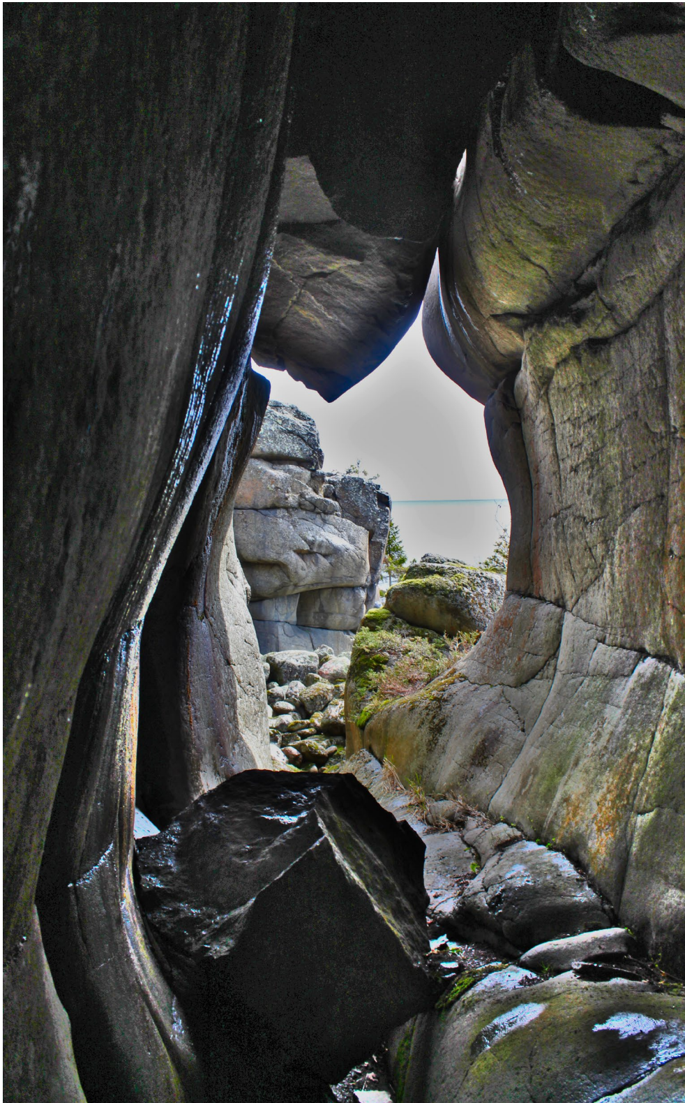
Figur 43. I den här lökgrottan i Rammbergets naturreservat i Höga Kusten har delar av taket rasat in.
